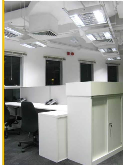
圖3.2.23 香港綠色建築議會辦公室室內 (資料來源：香港綠色建築議會)
