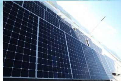
圖3.3.1 安裝在天台的光伏板 (資料來源：香港科技園公司)
