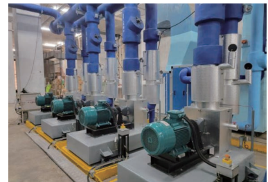
· 將恆速泵轉換為可變速泵
