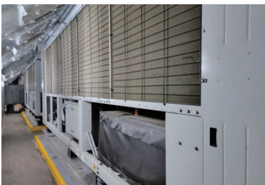
· 更換更高效率的冷水機組
