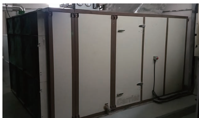
典型送風機機房的照片
