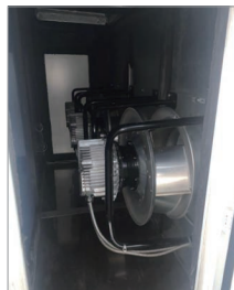
• 空气处理机组使用电子换相风机
