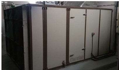
典型空气处理机组机房的照片
